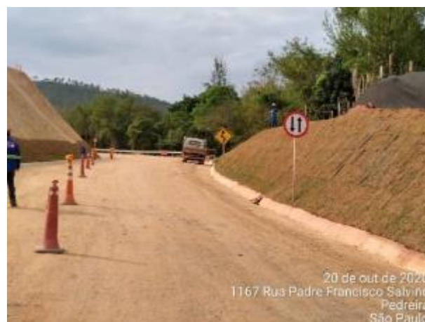
Foto 239 – Sinalização de sentido da via e cones segregando atividade do empreendimento no acesso MD-03. (Data:20/10/2020)
