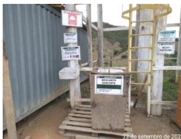
Foto 399 – Coletor instalado na área do canteiro operacional para descarte de vidro. (Data:22/09/2020)
