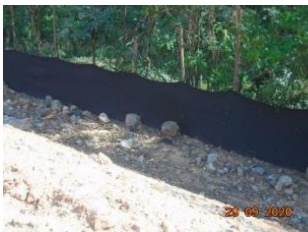
Foto 308 – Inspeção em contenção de tela filtro implantada próximo ao acesso da MD-03. (Data:29/09/2020)
