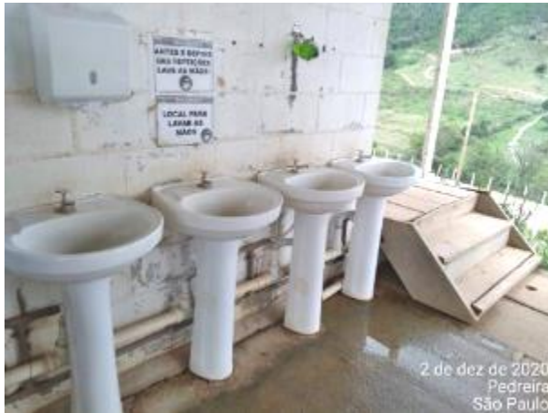
Foto 118 – Estrutura para higienização de mãos na área de vivência do canteiro operacional. (Data:02/12/2020)
