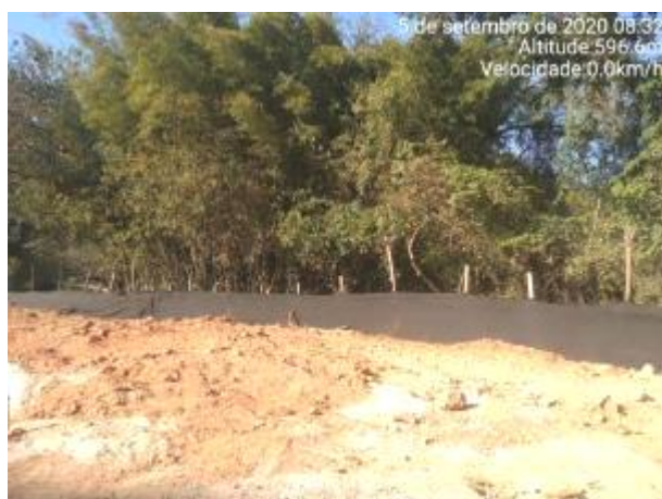
Foto 296 – Inspeção em contenção de tela filtro implantada próximo ao acesso da MD-03. (Data:05/09/2020)
