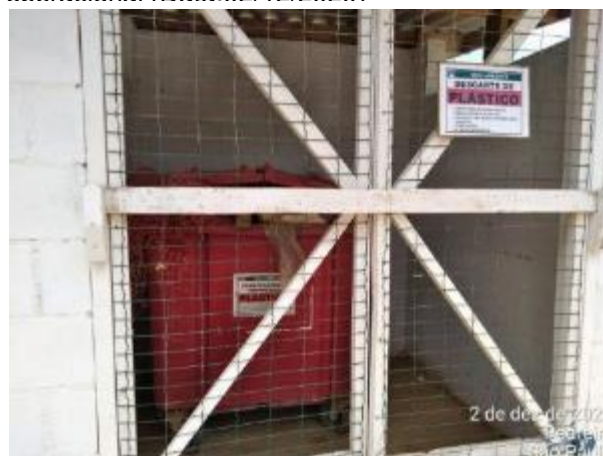
Foto 419 – Baia de resíduos de plástico no canteiro operacional. (Data:02/12/2020)
