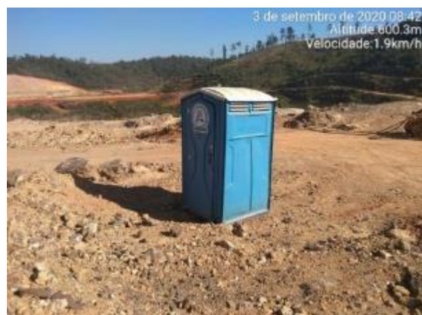
Foto 345 – Banheiro químico instalado próximo a área do eixo. (Data:03/09/2020)
