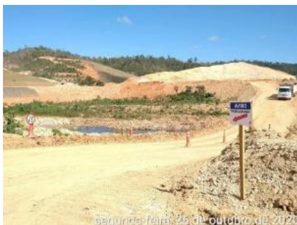
Foto 255 – Sinalização para ensecadeira de jusante. (Data:26/10/2020)
