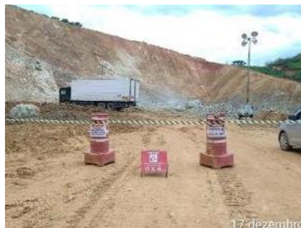
Foto 189 – Sinalização de bloqueio em área de carregamento de explosivos. (Data:17/12/2020)
