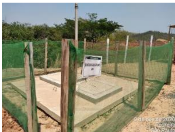
Foto 358 – Biodigestor 2 no canteiro administrativo. (Data:09/11/2020)
