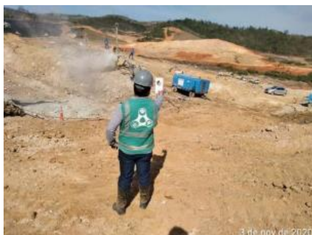
Foto 382 – Monitoramento de fumaça preta em equipamento. (Data:03/11/2020)
