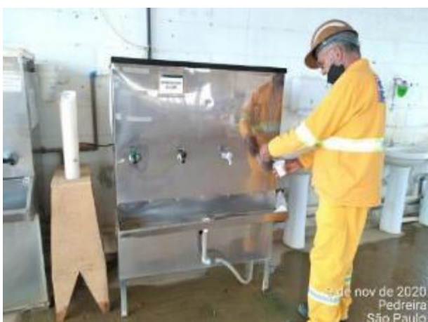
Foto 132 – Bebedouro 03 do canteiro operacional. (Data:09/11/2020)
