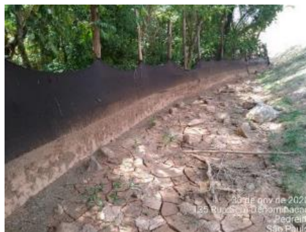
Foto 287 – Contenção do acesso da MD03. (Data:30/11/2020)
