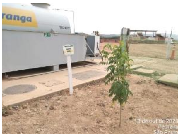
Foto 338 – Caixa SAO 1 no posto de abastecimento. (Data:13/10/2020)
