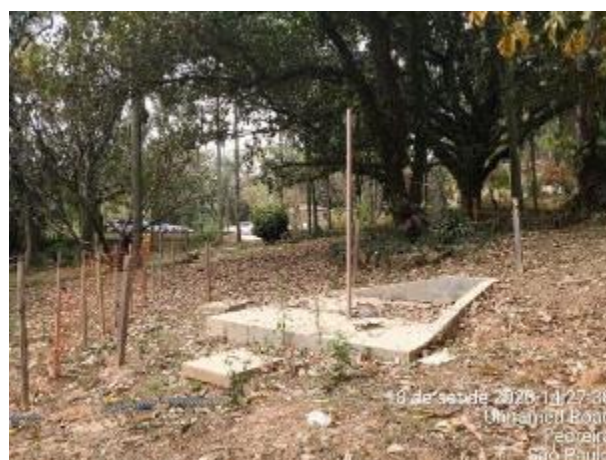
Foto 357– Biodigestor 2 no canteiro administrativo. (Data:18/09/2020)
