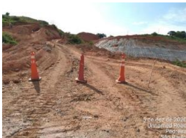
Foto 264 – Sinalização interditando passagem em via interna na margem direita. (Data:05/12/2020)
