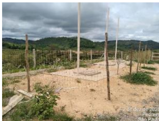
Foto 359 – Biodigestor 2 no canteiro administrativo. (Data:02/12/2020)
