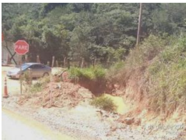
Foto 288 – Cacimba retendo água pluvial na margem direita. (Data:01/12/2020)
