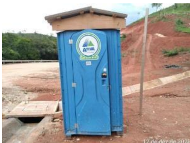
Foto 354 – Banheiro químico instalado na frente de serviço no acesso M.D. 03. (Data:12/12/2020)
