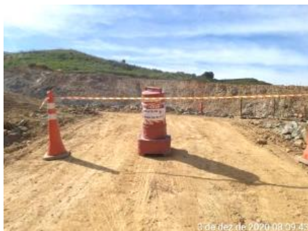
Foto 188 – Sinalização de bloqueio em área de carregamento de explosivos. (Data:03/12/2020)
