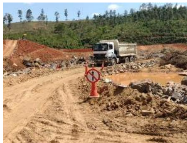
Foto 259 – Sinalização de sentido proibido em via interna na margem direita. (Data:11/11/2020)
