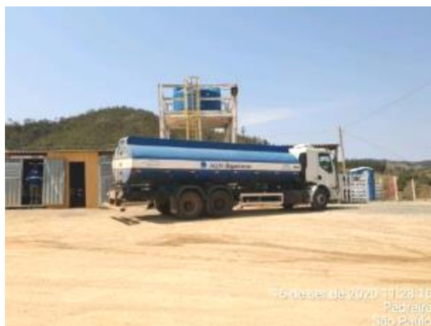
Foto 124 – Abastecimento da caixa d'água do canteiro operacional. (Data:15/09/2020)
